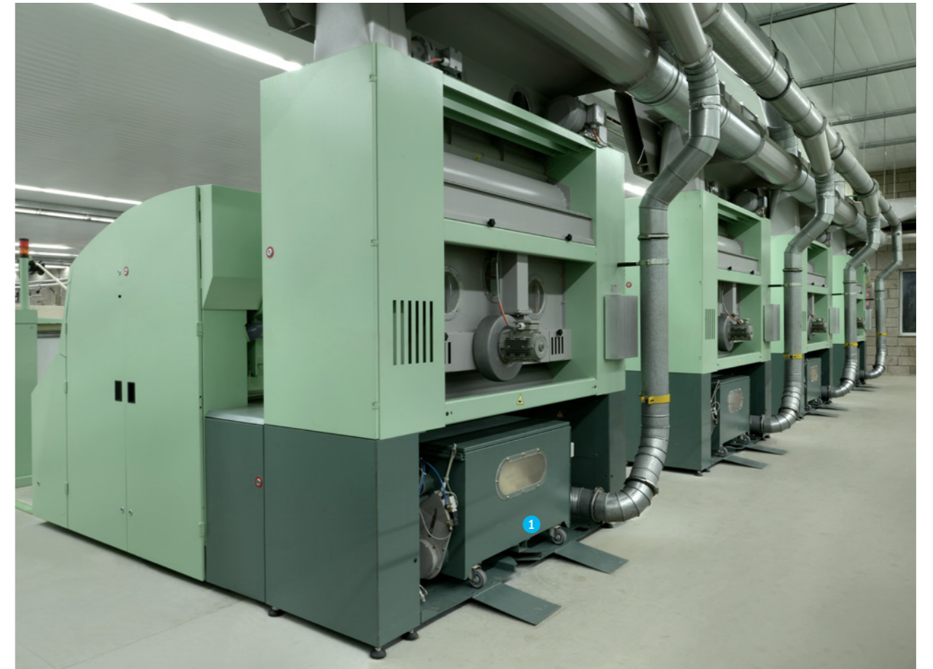
Ek brizör telef çıkarma 1 merkezi telef toplama tesisine bağılıdır.
